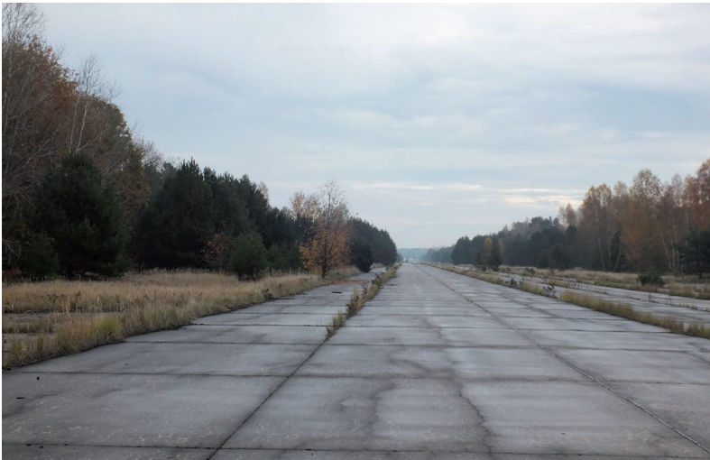
Abb. 105: Massive Relikte wie die Start- und Landebahn des ehemaligen Flugplatzes Sperenberg überdauern auch ohne umfangreiche Maßnahmen lange Zeiträume (Bild: V. Butt).
