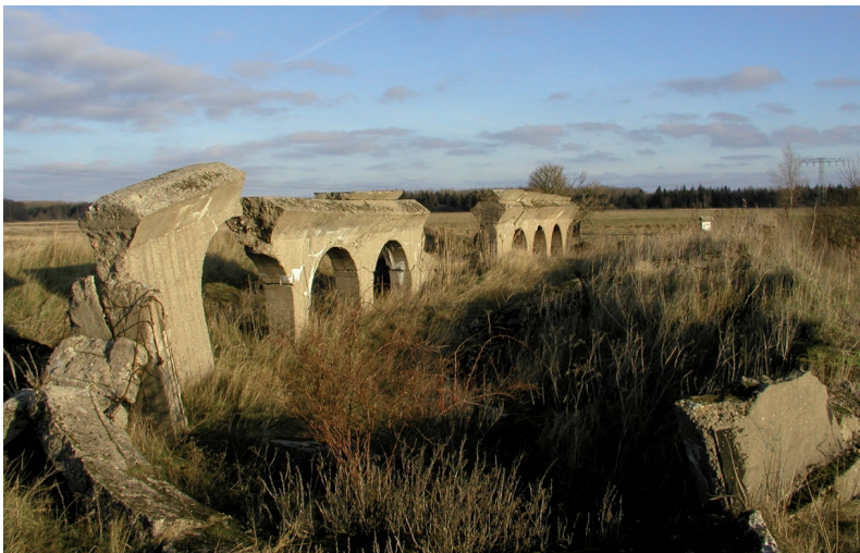
Abb. 106: Relikte in der ‚Denkmal-Landschaft Peenemünde‘. Objekte wie diese müssen von Bewuchs freigehalten werden, wenn sie erhalten und sichtbar bleiben sollen (Bild: Copyright HTM Peenemünde GmbH).
