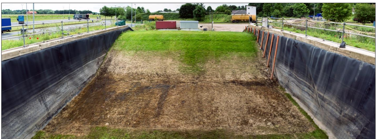
Abb. 5-25: Einstauversuch 3 – Zerstörte Rasenoberfläche durch Planenauflage
