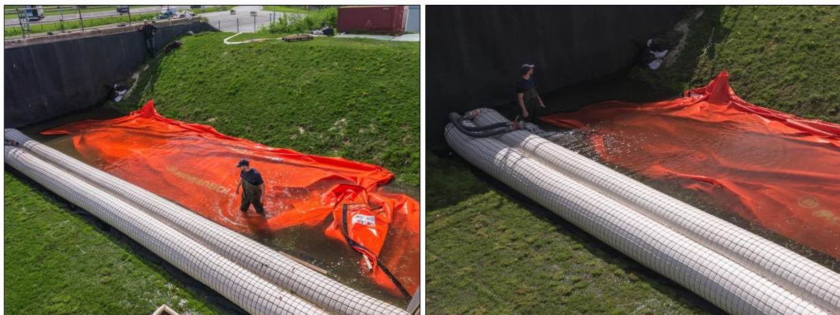
Abb. D-45: Mobildeich – Rückbau, Arbeitsschritte 1 und 2: Rückbau der vorgelagerten Dichtungsbahn (links); Entleeren der Schläuche durch freien Ausfluss (rechts)
