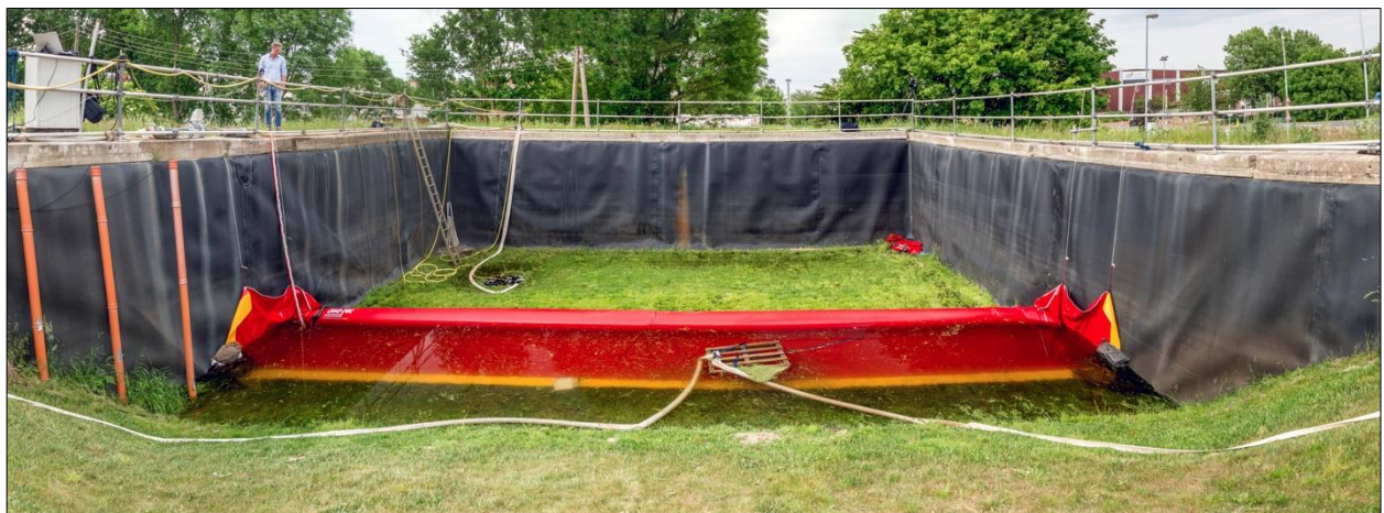
Abb. D-54: Öko-Tec-Schlauchwall – Belastungstest: Einstau mit einem Wasserstand von 0,60 m
