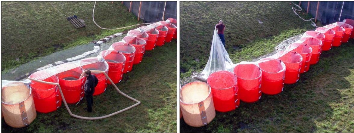
Abb. D-84: Aquariwa – Rückbau, Arbeitsschritte 1 und 2: Entleeren des Foliensacks mithilfe einer Tauchpumpe (links); Rückbau der vorgelagerten Dichtungsbahn (rechts)
