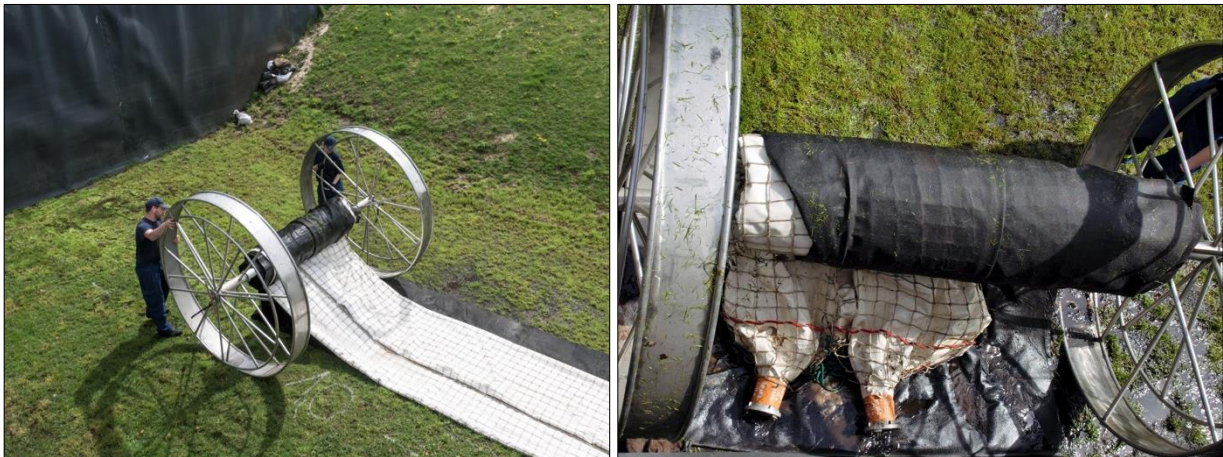
Abb. D-46: Mobildeich – Rückbau, Arbeitsschritt 3: Aufrollen der Schläuche mithilfe der Haspelräder (links); Restentleerung des Systems während des Aufrollvorgangs (rechts)
