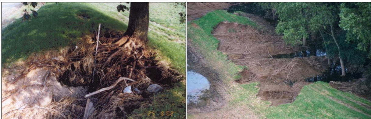
Abb. 3-8: Landseitige Böschungserosion infolge von Baumbewuchs und Überströmung (links); Bei Hochwasser freigelegte Durchwurzelung eines Deichs infolge von Baumbewuchs (rechts) (DWA, 2011)
