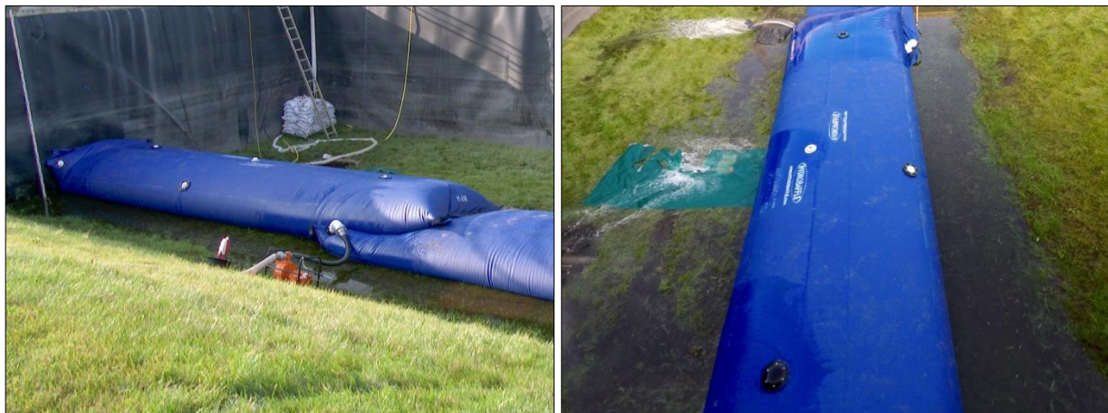
Abb. D-11: Hydrobaffle – Rückbau, Arbeitsschritt 1: Leeren des Hydrobaffles mithilfe von Pumpentechnik (links); Leeren des Hydrobaffles über den freien Ausfluss (rechts)
