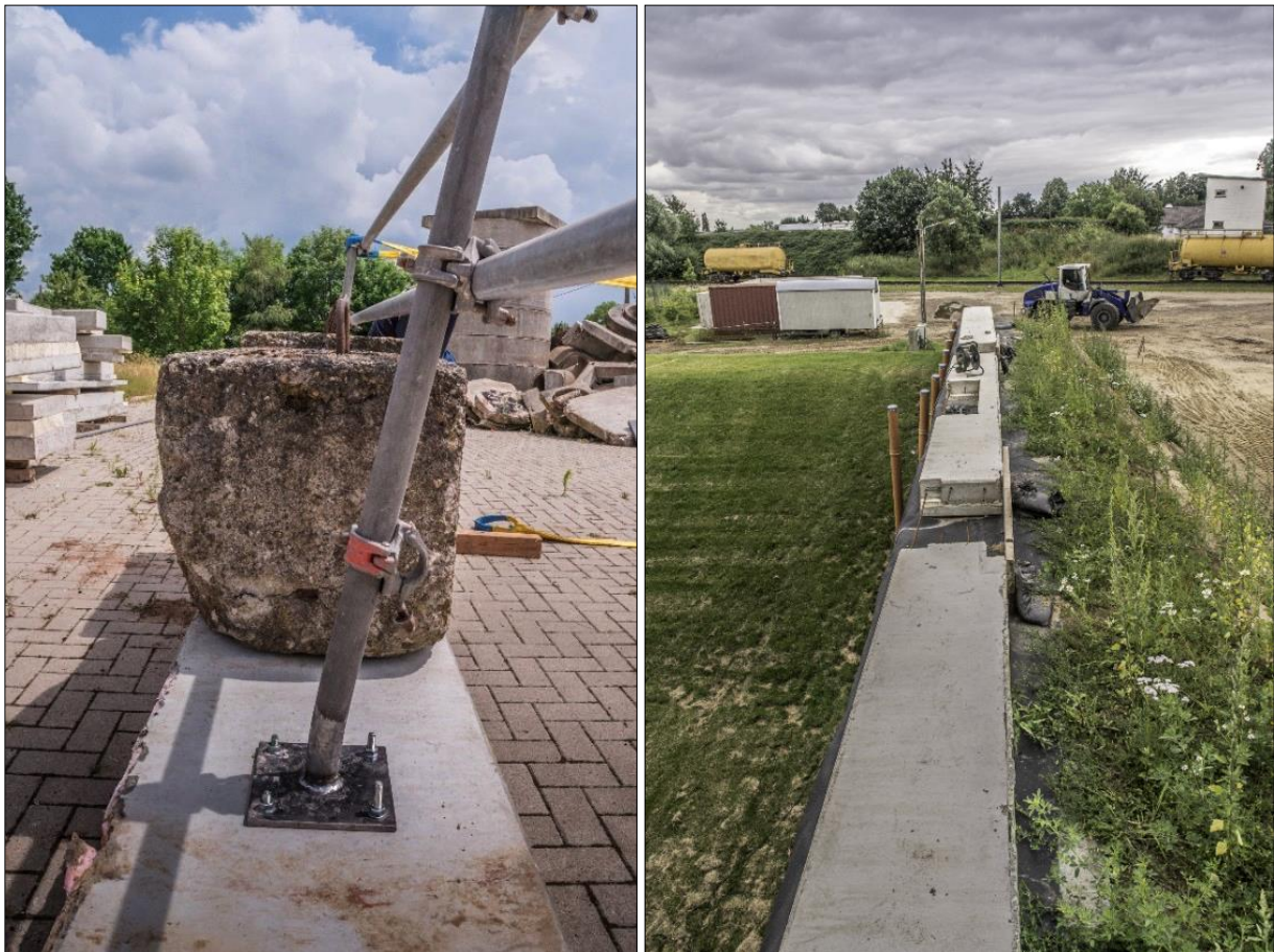
Abb. B-29: Beschädigtes Geländer nach maximaler Belastung (links); Einbau der Betonfertigteile (rechts)
