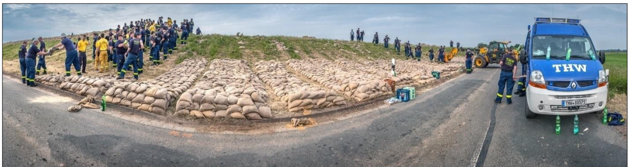
Abb. 1-1: Bau eines Auflastfilters aus Sandsäcken zur Sicherung der Binnenböschung des Elbedeichs bei Hitzacker im Juni 2013 (Foto: Bärbel Koppe)
