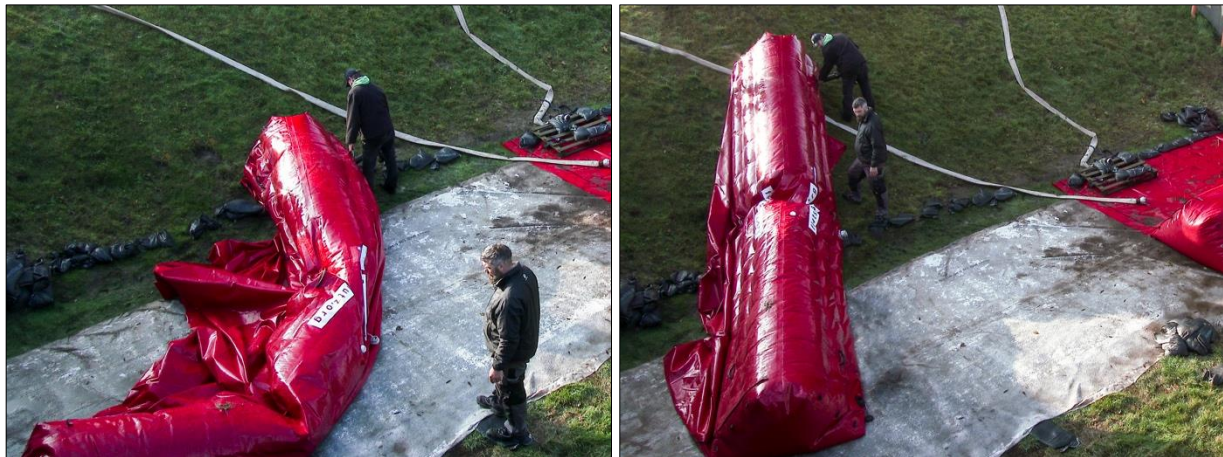
Abb. D-73: Flutschutz-Deichkade – Rückbau, Arbeitsschritt 3: Restentleerung der Schläuche durch leiten des Wassers in Richtung der Ventile auf gerader Fläche (links) und in Hanglage (rechts)
