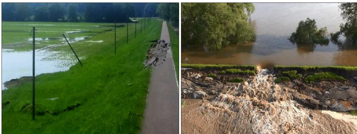
Abb. 3-9: Böschungsruftung in Breitenhagen am Saaledeich 2013 (links) mit anschließender Breschenbildung (rechts), (Heyer, et al., 2015)
