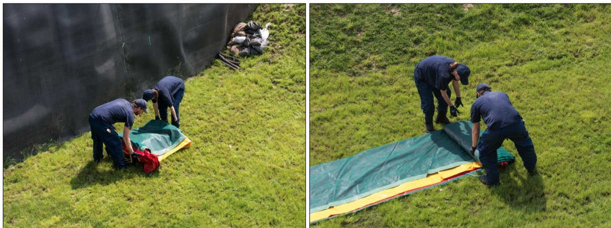
Abb. D-48: Öko-Tec-Schlauchwall – Aufbau, Arbeitsschritte 1 und 2: Positionierung des Öko-Tec-Schlauchwalls (links); Ausrollen des Öko-Tec-Schlauchwalls (rechts)
