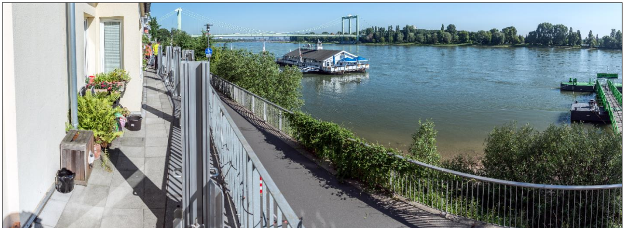
Abb. 6-2: Mobile Stützen, verbunden mit dem Fundament zum Aufbau des Dammbalkensystems in Köln-Rodenkirchen
