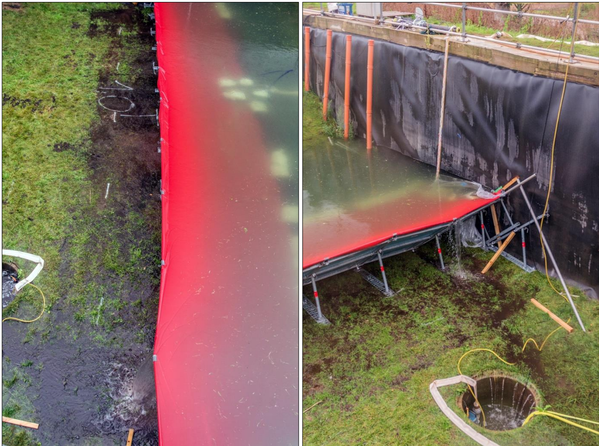
Abb. D-131: Plettac Aqua Defence – Belastungstest: Lokale Überströmung des Systems im Bereich des am tiefsten eingesunkenen Stützbocks, (Massolle et al., 2018)
