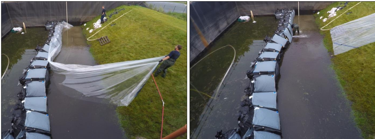
Abb. D-98: Indutainer – Rückbau, Arbeitsschritte 1 und 2: Entnahme der Sandsäcke und der vorgelagerten Dichtungsbahn (links); Öffnen der Ventile im unteren Bereich der Indutainer
