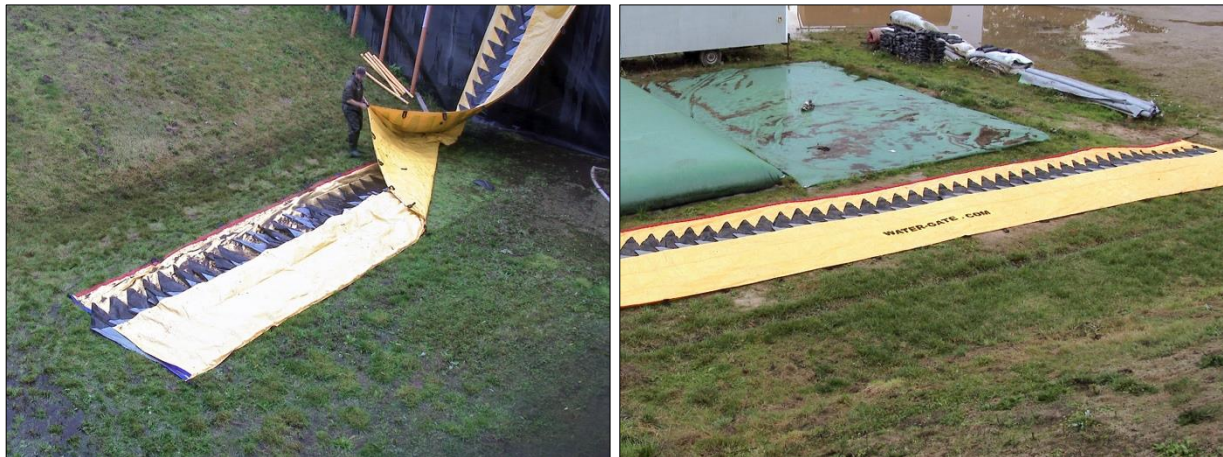
Abb. D-117: Megasecur Water-Gate – Rückbau, Arbeitsschritte 2 und 3: Entfernen des Restwassers (links); Auslegen des Systems für den Einrollvorgang (rechts)
