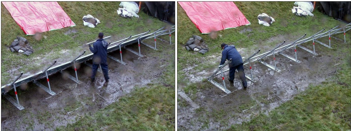
Abb. D-134: Plettac Aqua Defence – Rückbau, Arbeitsschritte 2 und 3: Entnahme der Platten-Randriegel und der unteren Hartschaumplatte (links); Rückbau der Aussteifungsrahmen (rechts)
