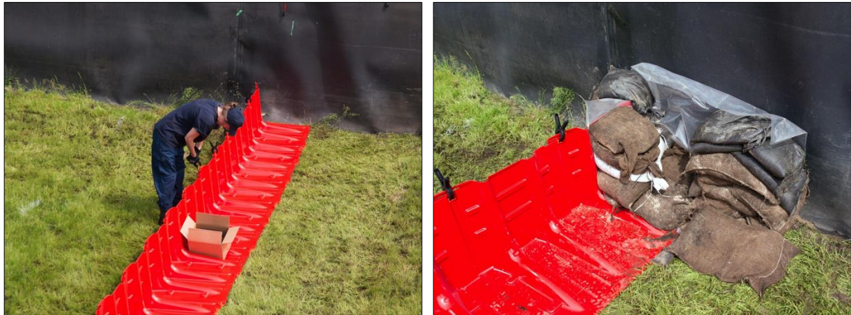
Abb. D-139: NOAQ Boxwall – Aufbau, 3. Arbeitsschritt: Sicherung der Elementstöße mit Klemmzangen (links); Randabdichtung mit Sandsäcken und Dichtungsbahn (rechts)
