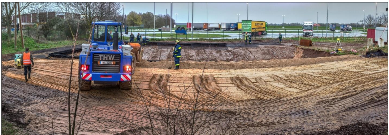
Abb. B-10: Kunststoffbewehrter Erdwall – Arbeitsschritt 5 – Einbringen und Verdichten von Bodenmaterial bis auf die Höhenlage des Stahlgitters
