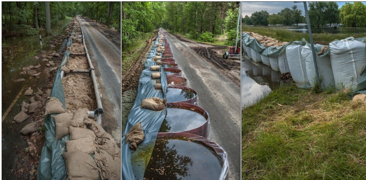
Abb. 6-12: Eingesetzte Beckensysteme beim Elbehochwasser 2013 in Gartow; Sandbefülltes Beckensystem vom Hersteller "Quickdamm" (links); Wasserbefülltes Beckensystem vom Hersteller "Aquariwa" (Mitte); Sandbefüllte BigBags (Hersteller unbekannt) (rechts), (Fotos: Bärbel Koppe)
