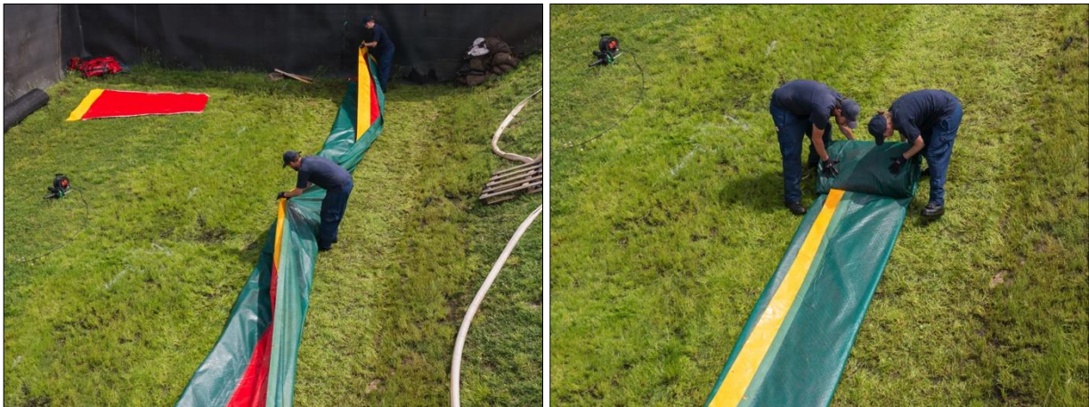
Abb. D-61: Öko-Tec-Schlauchwall – Rückbau, Arbeitsschritt 5: Zusammenlegen (links) und Aufrollen des Systems (rechts)
