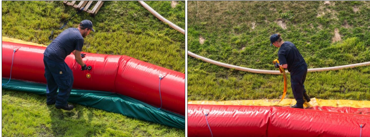
Abb. D-59: Öko-Tec-Schlauchwall – Rückbau, Arbeitsschritte 1 und 2: Öffnen des Ventils zur Systementlüftung (links); Rückbau des Bleibands (rechts)
