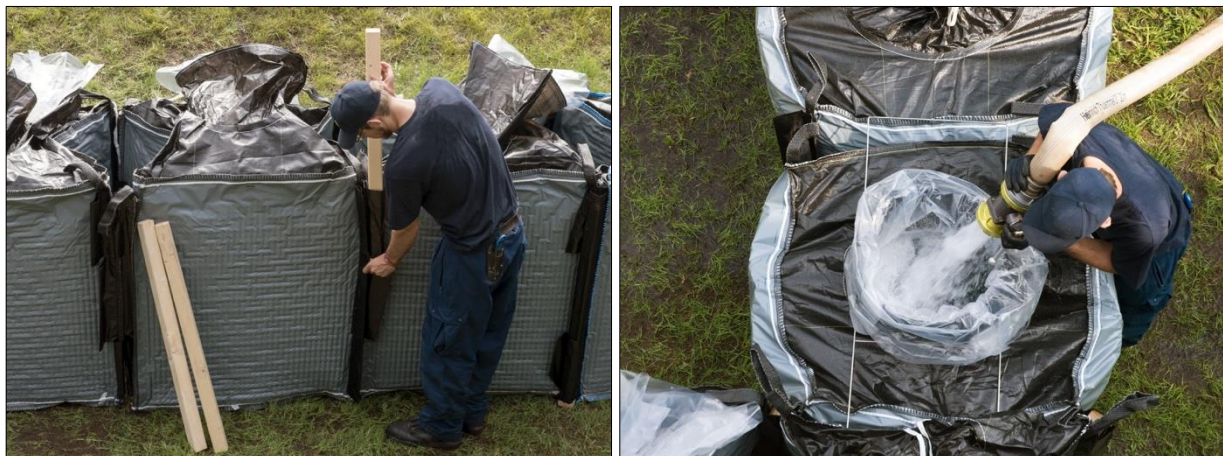
Abb. D-89: Indutainer – Arbeitsschritte 3 und 4: Die Indutainer mithilfe von Holzlatten verbinden (links); Befüllen der Indutainer mit der Einfüllhilfe (rechts)
