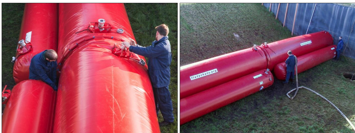
Abb. 7-15: Flutschutz-Doppelkammerschlauch – Aufbau, Arbeitsschritte 5 und 6: Verbinden der Systemenden mithilfe des Hohlsaums und dem Verbindungsseil (links); Wasserbefüllung der kleinen Kammern bei gleichzeitiger Entlüftung (rechts)
