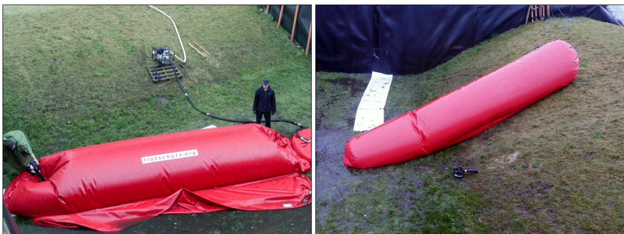
Abb. 7-24: Flutschutz-Doppelkammerschlauch – Rückbau, Arbeitsschritt 2: Füllen der Kammer mit Luft zur Vereinfachung der Restentleerung (links); Zusätzliches Hochlegen der Systemelemente zur Restentleerung (rechts)
