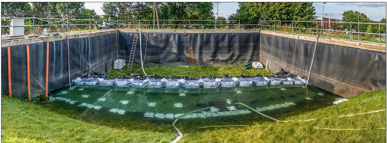
Abb. D-92: Indutainer – Belastungstest: Einstau mit einem Wasserstand von 0,60 m
