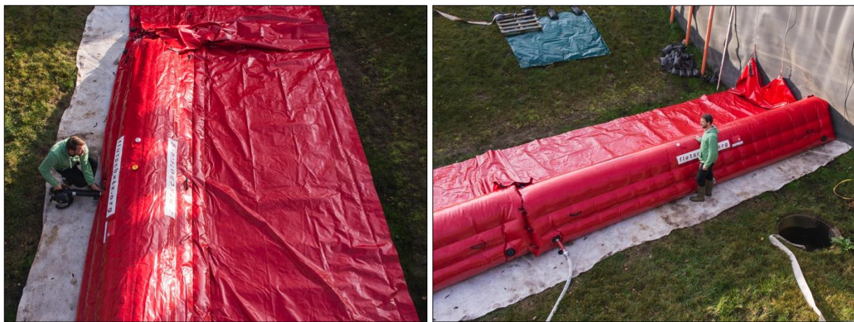
Abb. D-65: Flutschutz-Deichkade – Aufbau, Arbeitsschritte 5 und 6: Befüllen der Flutschutz-Deichkade mithilfe eines Luftgebläses (links); Befüllen der Flutschutz-Deichkade mit Wasser bei gleichzeitiger Entlüftung (rechts)
