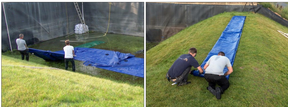
Abb. D-12: Hydrobaffle – Rückbau, Arbeitsschritte 2 und 3: Anheben der Schläuche und diagonales Verschieben zur Leitung des Wassers zu den geöffneten Ventilen (links); Falten und zusammenrollen der einzelnen Schläuche (rechts)
