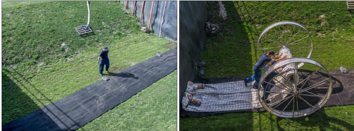
Abb. D-35: Mobildeich – Aufbau, Arbeitsschritte 1 und 2: Verlegen und Beschweren des Drainagevlieses entlang der Schutzlinie (links); Ausrollen des Mobildeichs mithilfe der Haspelräder (rechts)
