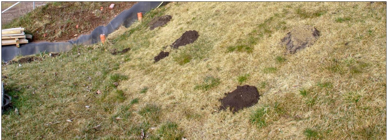
Abb. 5-38: Beschädigung des Testdeichs durch einen Maulwurf
